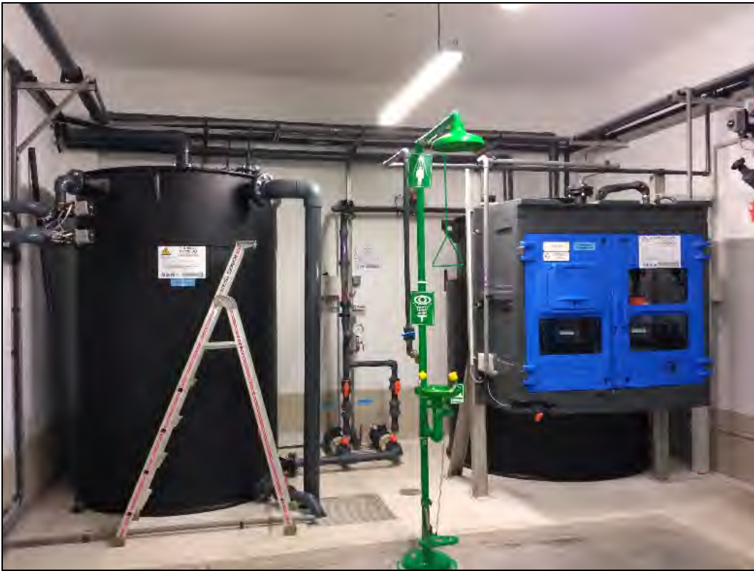
Photo 9 : Traitement des nitrates (chlorure de sodium) et mise à l'équilibre de l'eau grâce à la soude
