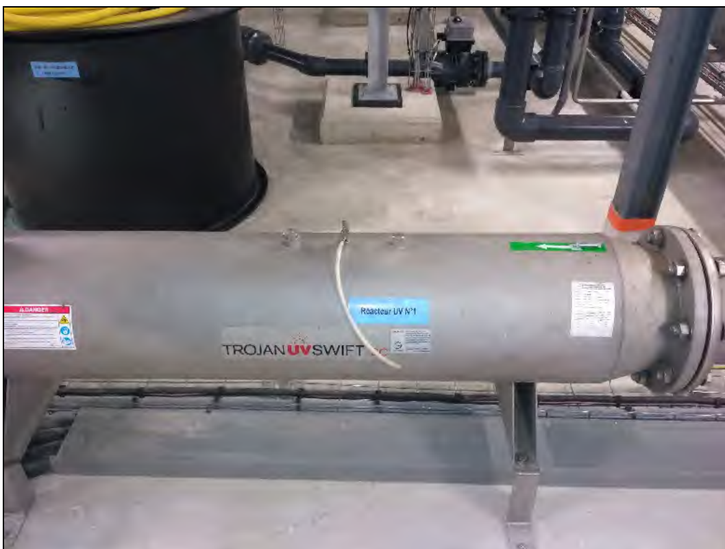
Photo 10 : Désinfection par traitement UV
